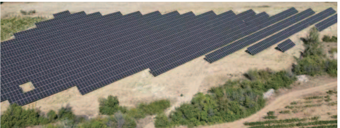
5.5MW 地面电站项目
