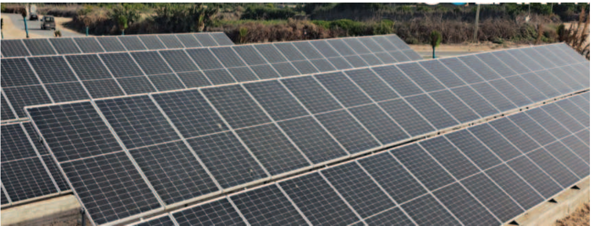
295kW 地面电站项目
