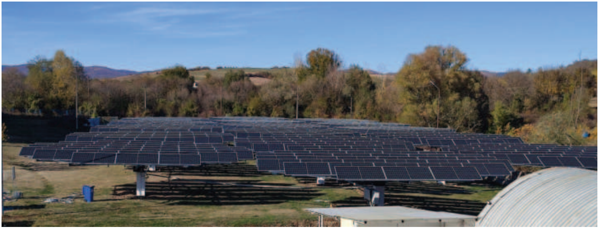
640kW 工商业项目
