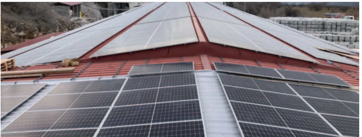
700kW 工商业项目
