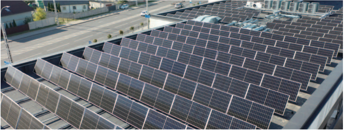
Proyecto industrial en cubierta de 100kW
