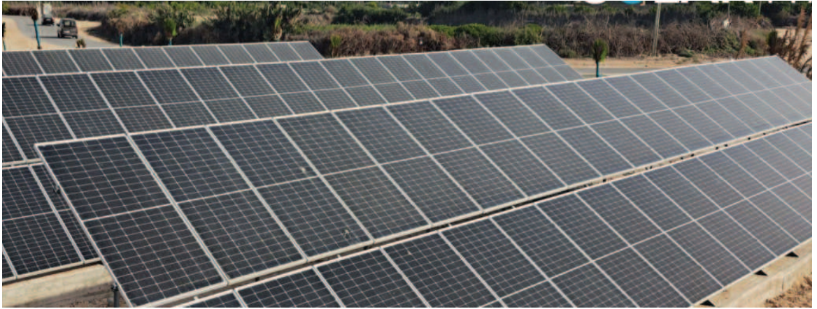
Proyecto de central fotovoltaica de 295 kW
