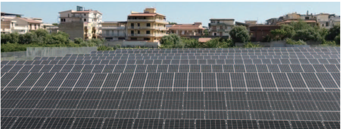
Proyecto de la Comunidad de Energías Renovables de 750kW
