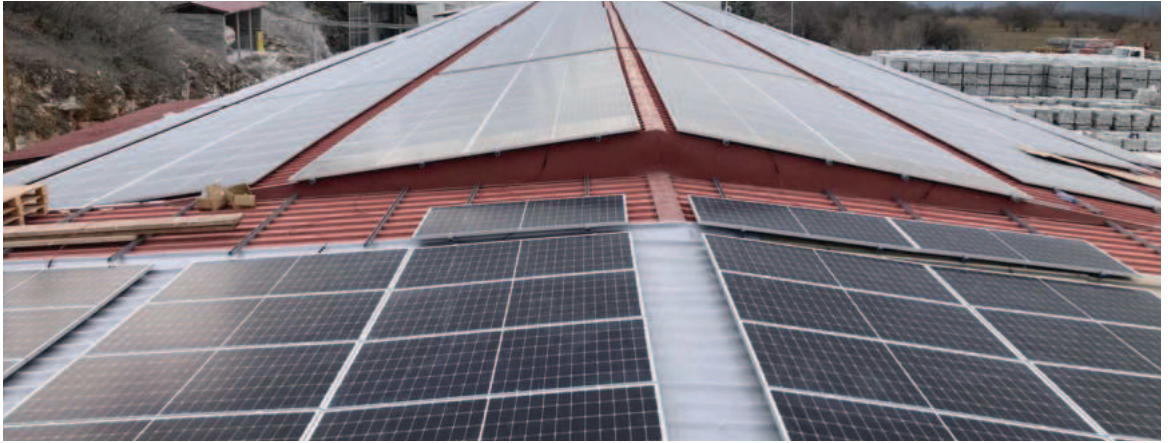
Proyecto industrial en cubierta de 700kW
