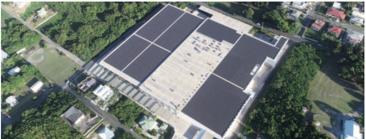
Proyecto comercial en cubierta 8MW
