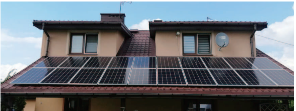
Proyecto residencial de 8kW
