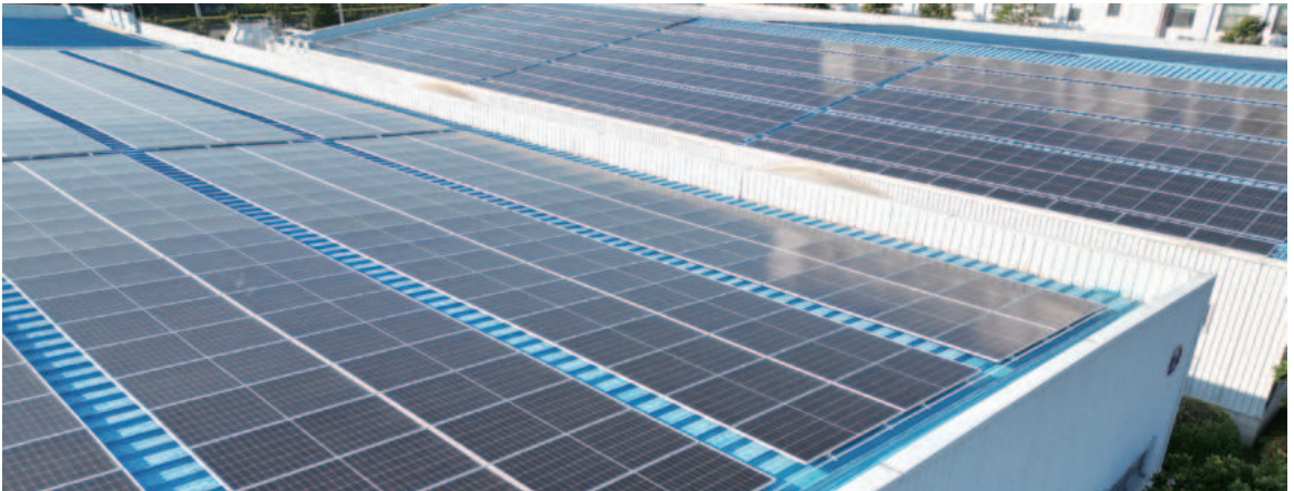
Proyecto industrial en cubierta de 1MW
