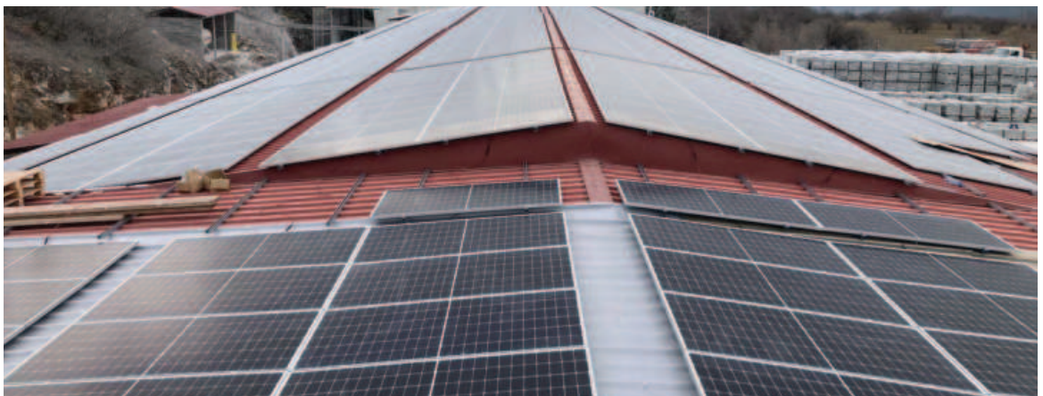
700kW Projet de toiture industrielle
