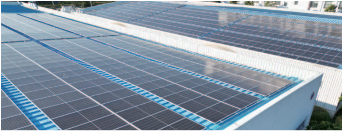
1MW Projet de toiture industrielle
