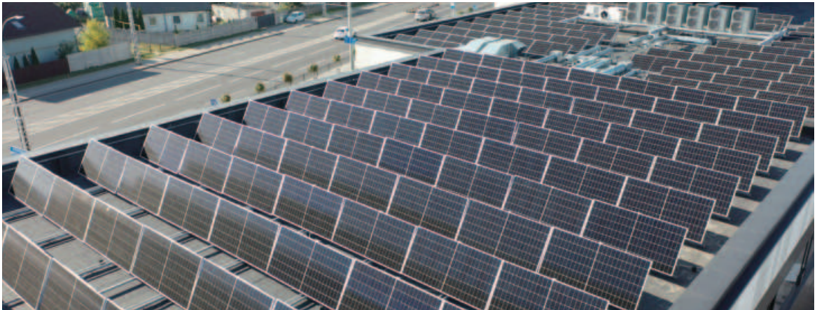
100kW Projet de toiture industrielle
